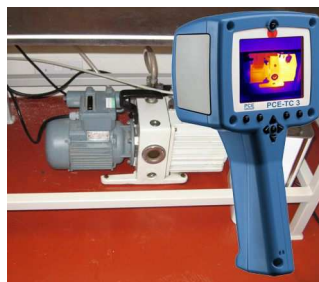
Beispiel der Thermographie einer Motor - Getriebeeinheit mit der PCE-TC 3
